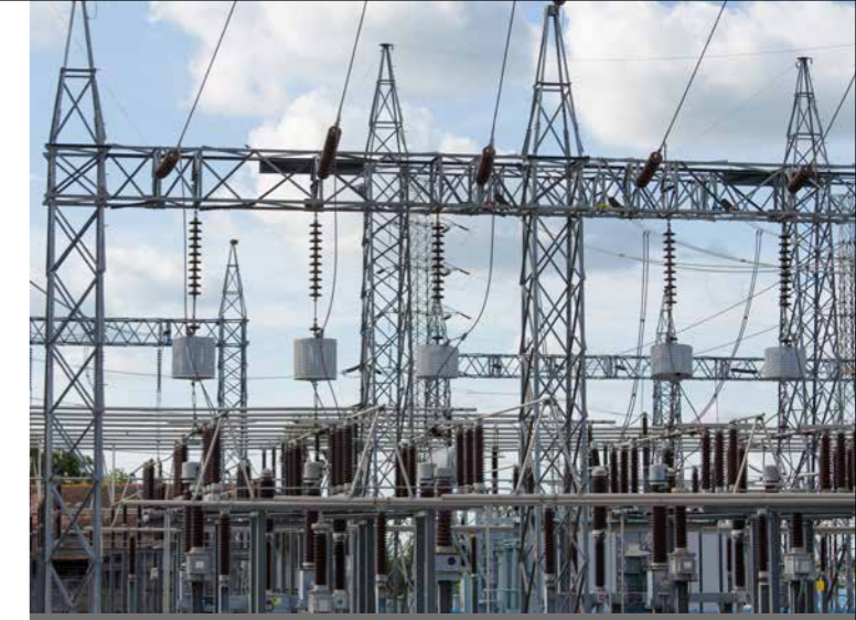
Eine verbesserte Netzzustandsschätzung kann wichtige elektrische Netzbetriebsmittel wie Leitungen, Sammelschienen und Transformatoren entlasten
